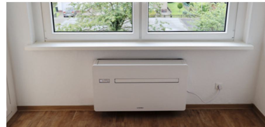
Die Luft-Luft-Wärmepumpe in Braunschweig-Broitzem sorgt für eine warme Wohnung im Winter und kühlt im Sommer.
