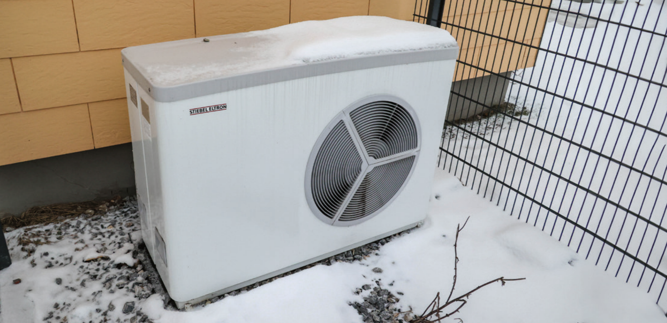
Die Luft-Wasser-Wärmepumpe in unserem Bestand in Braunschweig-Lehndorf
